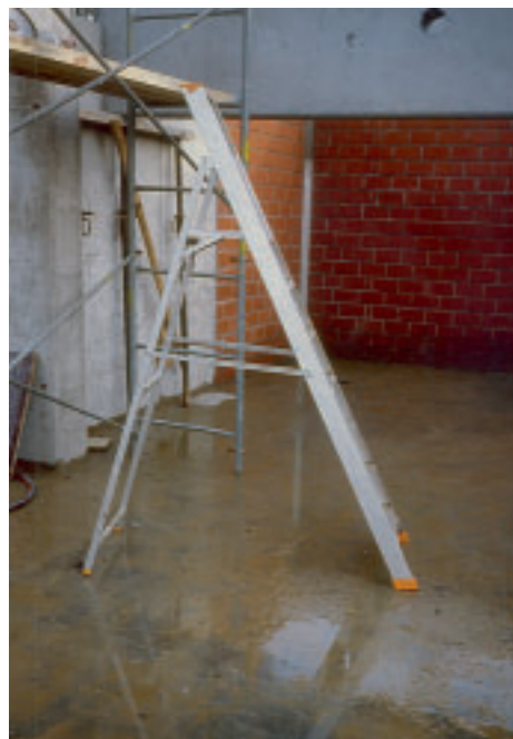
Figuur 11: Een ladder op een gladde betonvloer plaatsen kan zware ongevallen tot gevolg hebben
